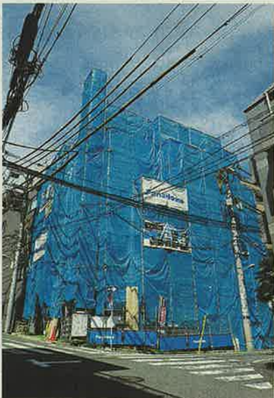
パナホームは都心部を中心に攻勢をかける(都内で建築中の物件)
